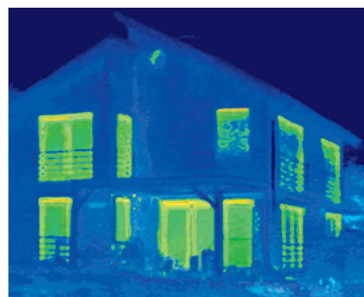
Po svědomité instalaci nových oken Schüco Corona CT 70 Classic dokazuje termografie vysoký energetický výnos investice. Původní energetická ztráta byla téměř beze zbytku eliminována.
