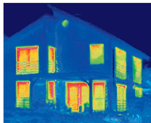
Infračervený termografický snímek jasně ukazuje, v jakých místech domu dochází k nekontrolovatelné ztrátě energie. Červená značí tepelnou a tudíž energetickou ztrátu.
