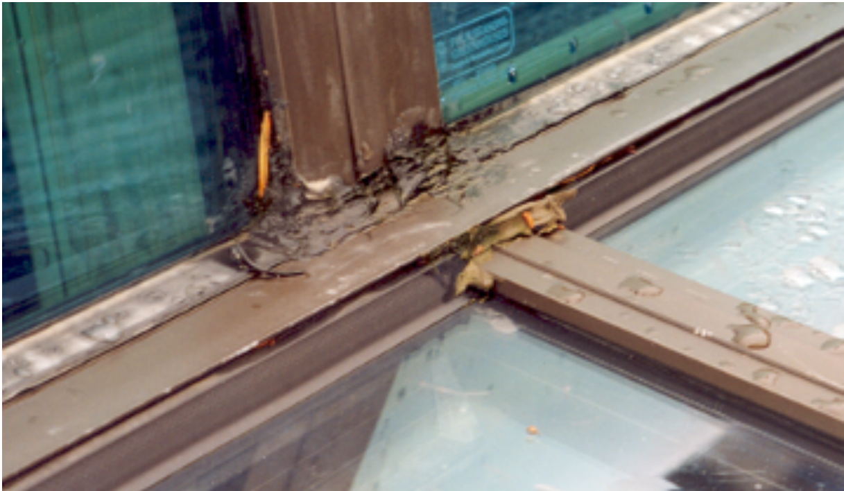
Manglende kunnskap fører ofte til feilbruk av fugemasse.
