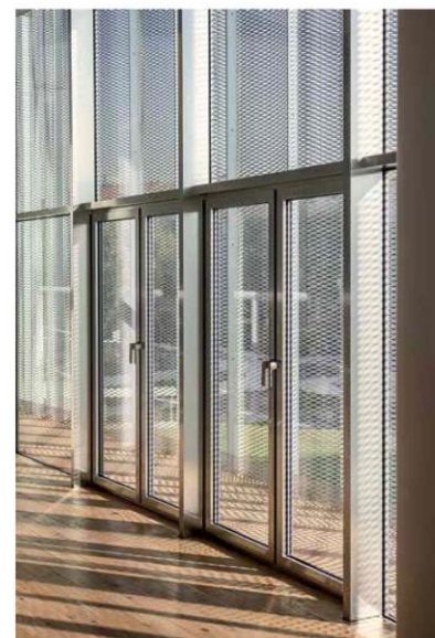
Essendo protetti da una rete esterna sul perimetro, i vetri sono basso emissivi con trasmissione luminosa elevata (Foto Filippo Fortis)
