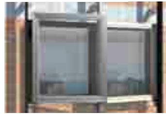
3. Die Fensterelemente: Während sie von außen montiert werden, bleiben die alten Fenster an Ort und Stelle.
