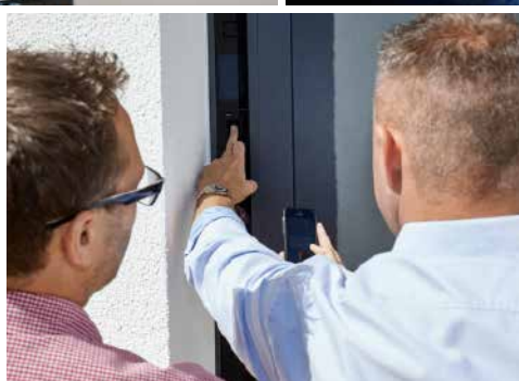
Voraussetzung für den reibungslosen Einbau ist eine gute Teamarbeit, auch gewerkeübergreifend: Kabel sollten bereits verlegt sein.
