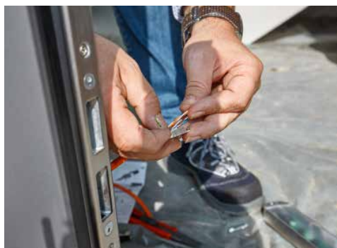
Die vorgefertigten Stecker lassen sich mit wenigen Handgriffen verbinden. Bild rechts: Die Steuerungseinheit, der IP Secure Connector, dient der erhöhten Sicherheit für Türöffner und Netzwerk.
