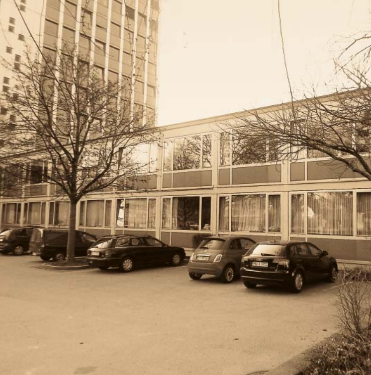
Das Landratsamt in Rottweil vor der Sanierung: Beide Gebäude- teile stammen aus dem Jahr 1959.
